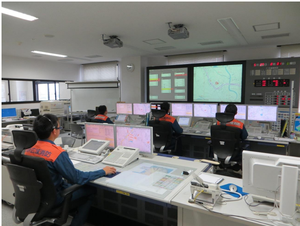
通信指令センター
