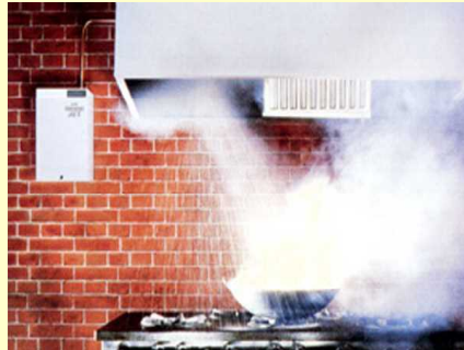
自動消火装置
